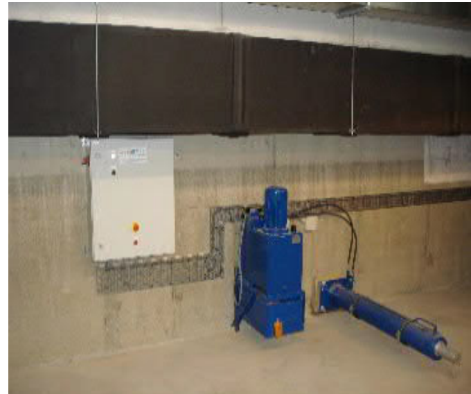
Hubzylinder und Hydraulikantrieb
