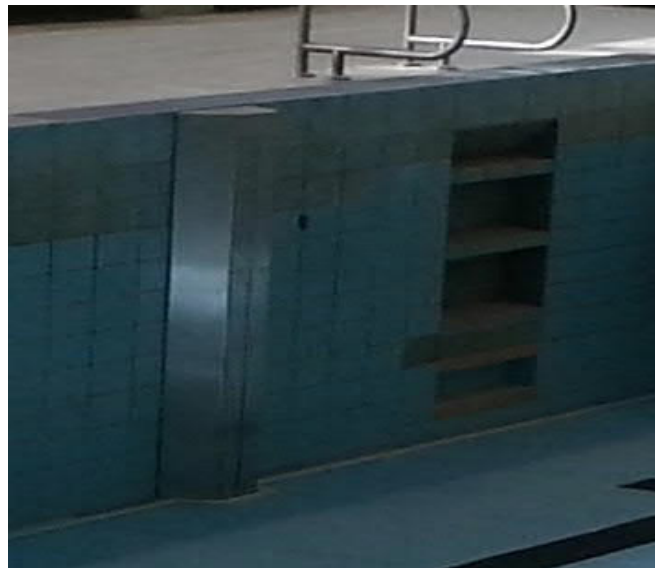
im Becken angeordnete (verkleidete) Vertikalspindel
